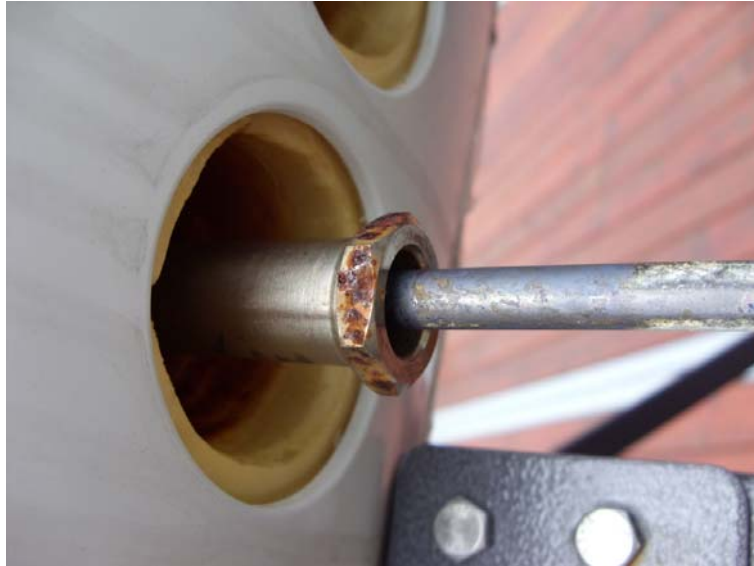
Abbildung 6: Manche der Verschraubungen der Wärmerohre weisen Korrosion auf. Some of the screwings are corroded.
